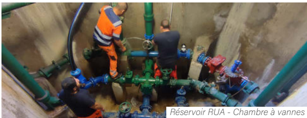
Réservoir RUA - Chambre à vannes
